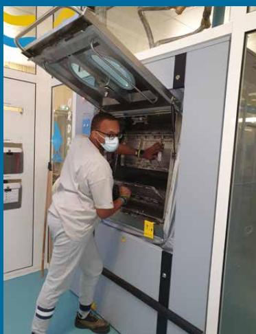
Déchargement de la nouvelle laveuse
